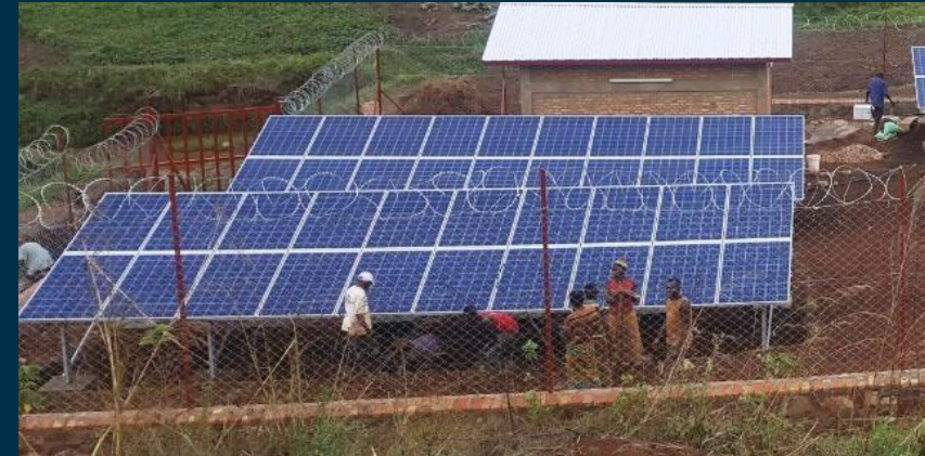
10. RUSZI SOLAR FARM
